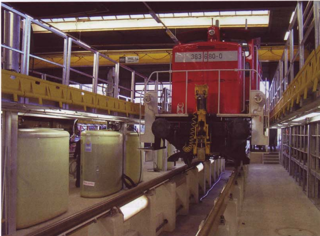
Die Zusammenlegung zweier Werkshallen zum neuen, 5.100 m 2 großen Kombi-Instandhaltungswerk „Güterwagen-Servicestelle Saarbrücken Nord“ ermöglicht eine besondere Wirtschaftlichkeit und die Sicherung von rund 140 Arbeitsplätzen am Standort Saarbrücken
